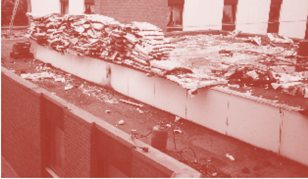
Gravierende Fehler an der Dachabdeckung des Haus Köster 2
