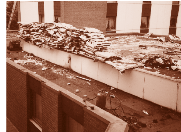
Gravierende Fehler an der Dachabdeckung des Haus Köster 2
